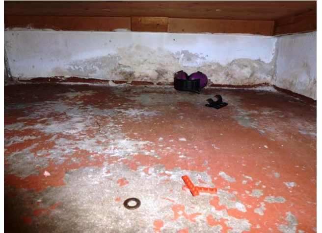
Verkstad: Kraftiga putsskador och färgsläpp
