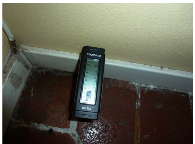
Gillestugan: påbyggd innervägg, 17% fuktkvot, saltutfällning på golvet
