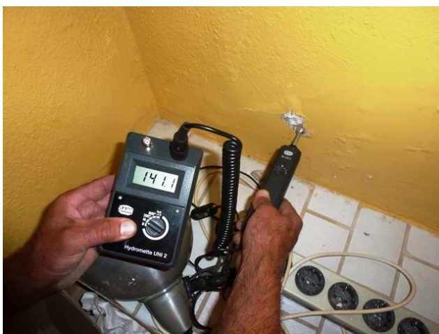
Dusch/Förrum: mycket höga fukthalter i fristående mellanvägg, putsskador
