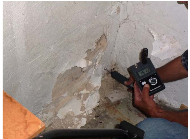
Matkällare: mycket höga fukthalter, kraftiga putsskador, smuts
