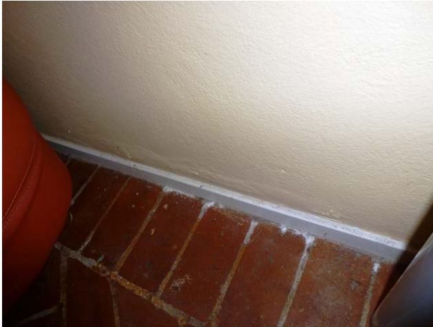
Gillestugan: mellanvägg, blåsor i färgen, saltutfällningar på golvet
