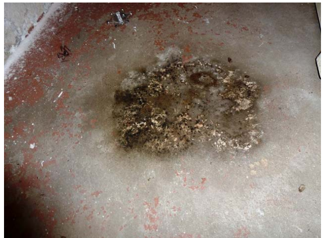
I förråd under stora källartrappan: mycket höga fukthalter, mögel, saltutfällningar, illalukt
