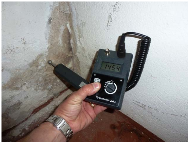
Förråd-3: mycket höga fukthalter, kraftiga putsskador
