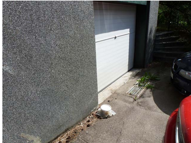
Markfuktskador i fasaden
