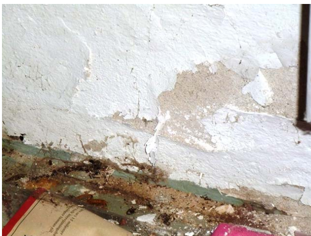
Matkällare: kraftiga putsskador, smuts
