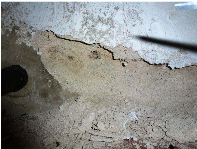
Torkrum: Kraftiga putsskador och färgsläpp
