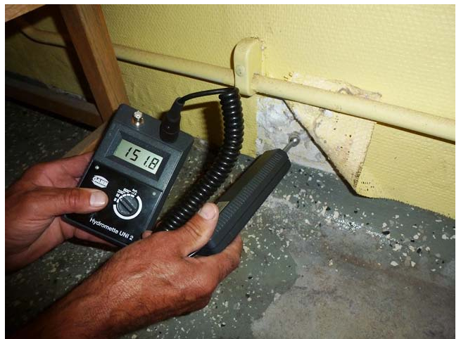
Tvättstuga: mycket höga fukthalter, tapetsläpp. Golvet är målat med diffusionstät färg.
