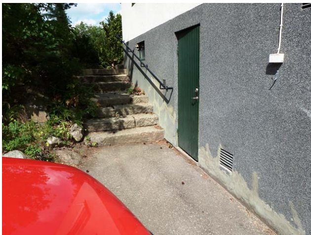
Markfuktskador i fasaden
