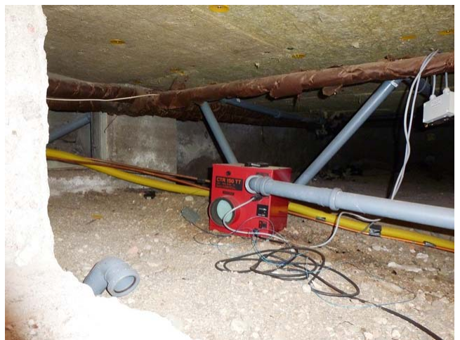
Krypgrund med avfuktare
