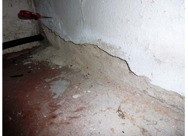
Torkrum: Kraftiga putsskador och färgsläpp
