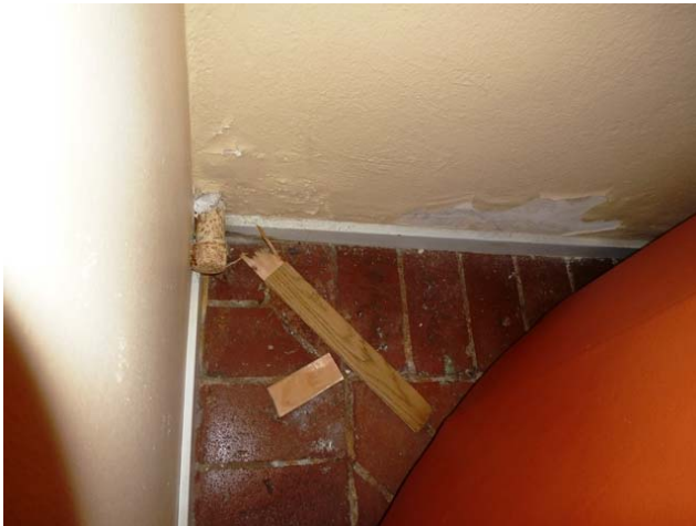
Gillestugan: mellanvägg, putsskador och färgsläpp
