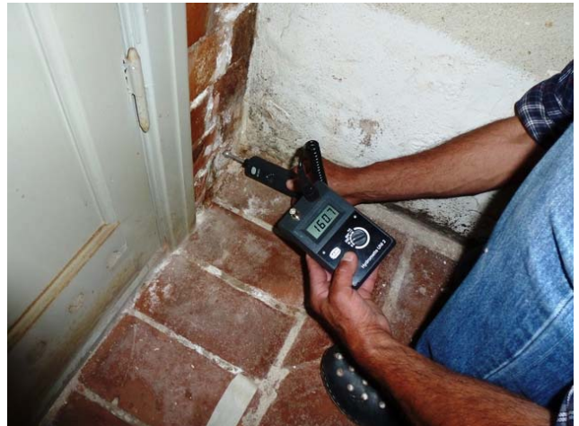
Utanför förråd under stora källartrappan: extremt höga fukthalter, mögel, saltutfällningar, illalukt
